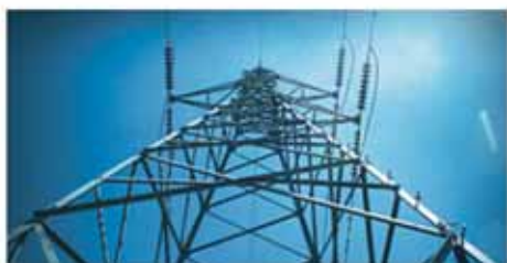
Alta y Baja Tensión
