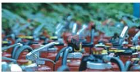
Protección Contra Incendios
